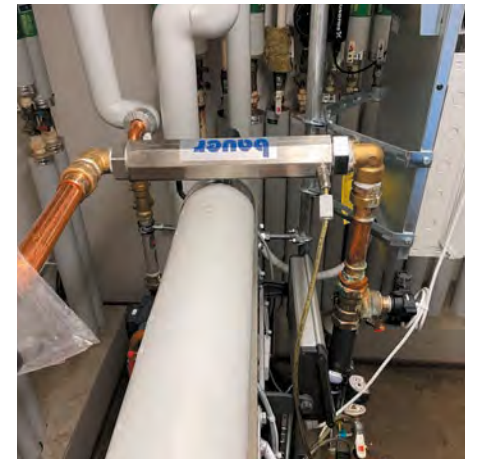
Vedenkäsittelyosa liitettynä lämmitysjärjestelmään
